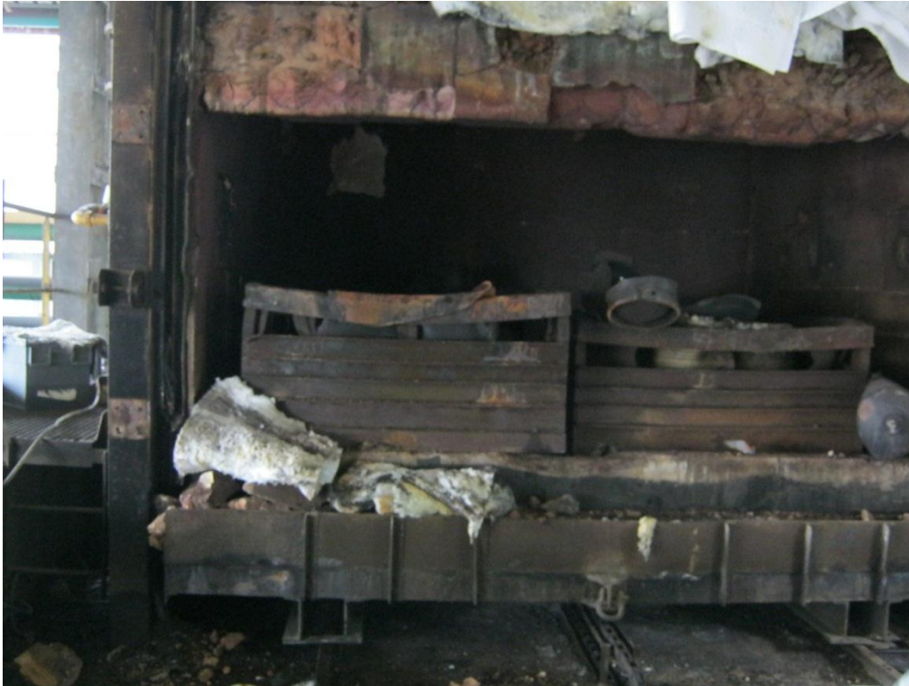
Explosion dans le four à cuivre d'un incinérateur de déchets dangereux (ARIA 45127)
